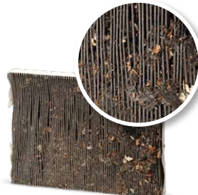
Sin mantenimiento de la climatización
