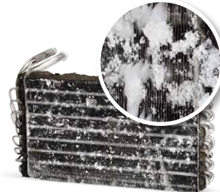
Sin mantenimiento de la climatización
